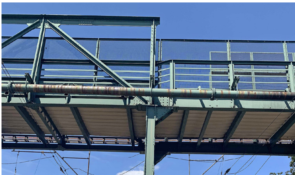
Obr. 3.168. Původní příhradová konstrukce a vložené pole na novém pilíři Fig. 3.168 New pier with the original truss bridge structure and the additional span
