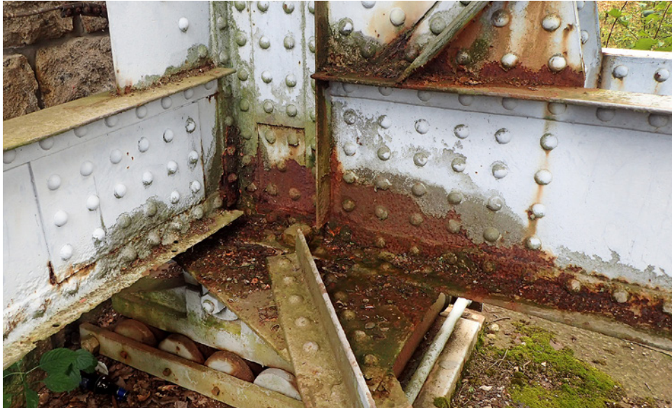
Obr. 3.8. Detail poškození nad opěrou Fig. 3.8 Detail of damage above the abutment
