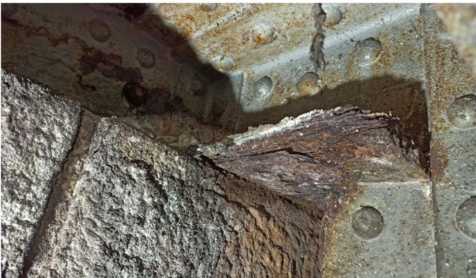
Obr. 3.34. Ukázka rozsáhlého poškození NK na přesahu přes závěrnou zídku Fig. 3.34 Example of extensive damage to the superstructure at the overlap over the end wall
