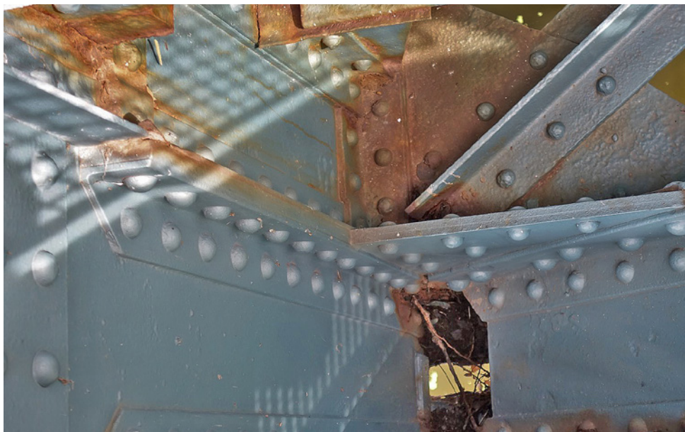
Obr. 3.119. Korozní oslabení styčnickových plechů u dolního pásu Fig. 3.119 Corrosion weakening of the connection plates at the lower chord
