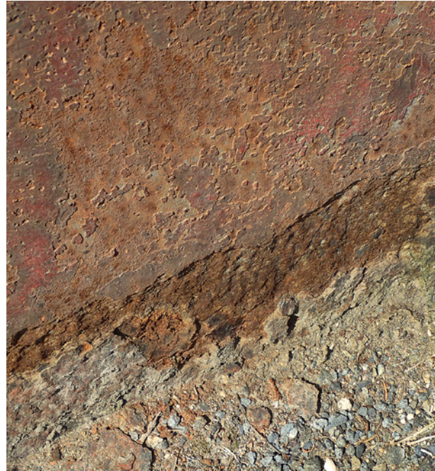
Obr. 3.75. Důlková koroze hlavního nosníku v úrovni vozovky Fig. 3.75 Corrosion of the main girder at deck level
