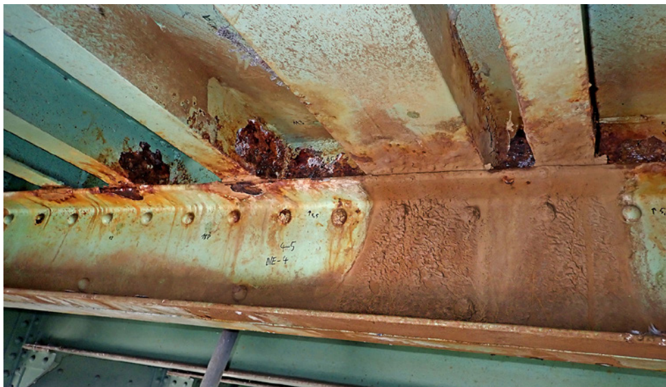
Obr. 3.108. Trhliny ve svarech mostovky, zatékání a vyplavování nečistot Fig. 3.108 Cracks in bridge deck welds, leakage and leaching of dirt
