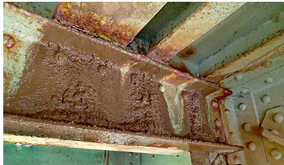
Obr. 3.109. Trhliny ve svarech mostovky, zatékání a vyplavování nečistot Fig. 3.109 Cracks in bridge deck welds, leakage and leaching of dirt
