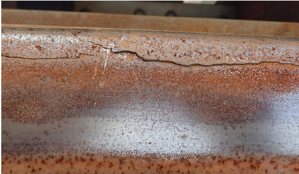
Obr. 3.56. Praskliny v pojížděné hraně pravé kolejnice Fig. 3.56 Cracks in the rail
