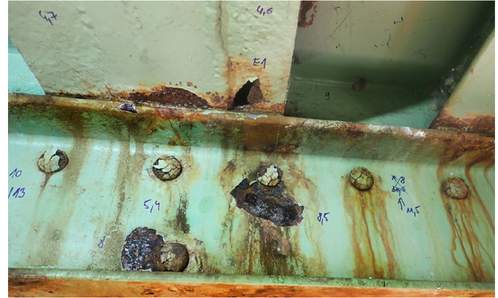
Obr. 3.111. Štěrbinová koroze mezi podélnými výztuhami a příčnkem, koroze prvků mostovky Fig. 3.111 Crevice corrosion between longitudinal stiffeners and crossbeam, corrosion of bridge deck members
