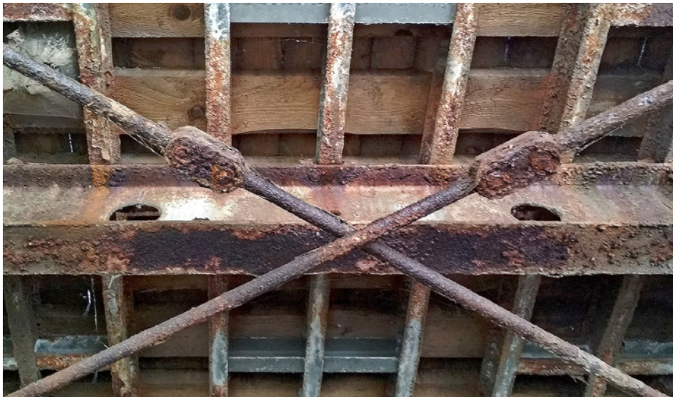
Obr. 3.151. Povrchová koroze prvků mostovky Fig. 3.151 Surface corrosion of the deck members
