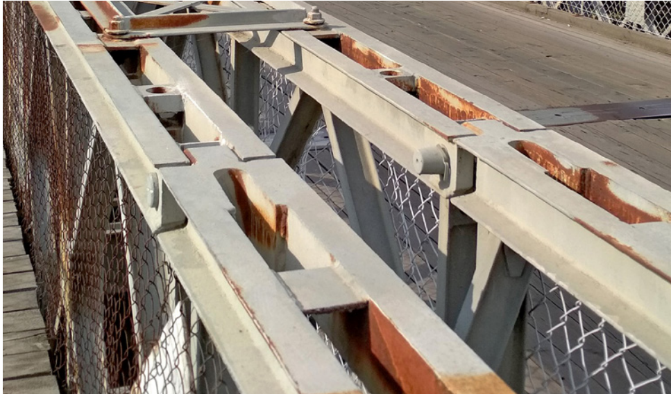
Obr. 3.149. Povrchová koroze horního pásu Fig. 3.149 Surface corrosion of the upper chords
