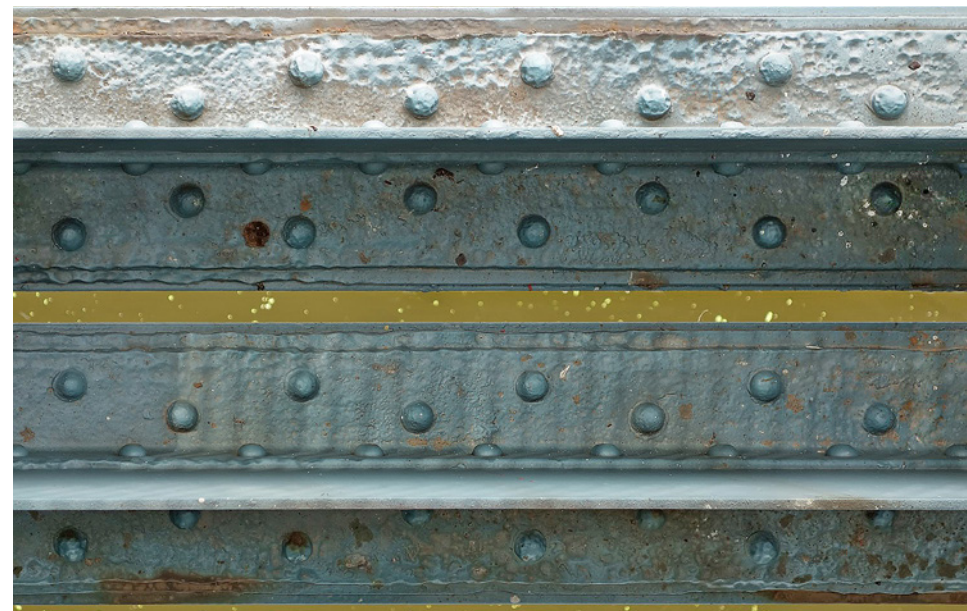
Obr. 3.120. Korozní oslabení krčních úhelníků dolního pásu Fig. 3.120 Corrosion weakening of the neck angles of the lower chord
