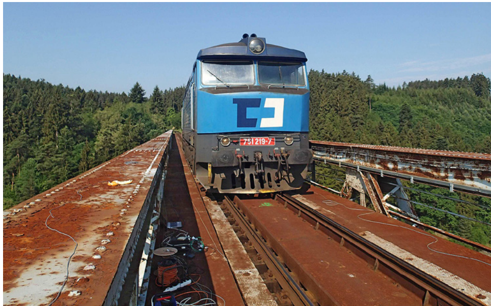
Obr. 3.4. Pohled na břemeno na mostě při SZZ Fig. 3.4 View of the locomotive on the bridge during SLT
