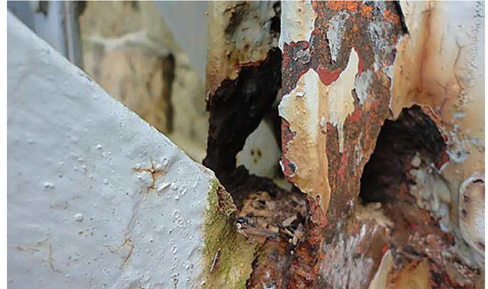
Obr. 3.9. Svislice 30 – prorezivění přírub krčních úhelníků (SUDOP Praha) Fig. 3.9 Vertical no. 30 – corrosion of angle flanges (SUDOP Praha)
