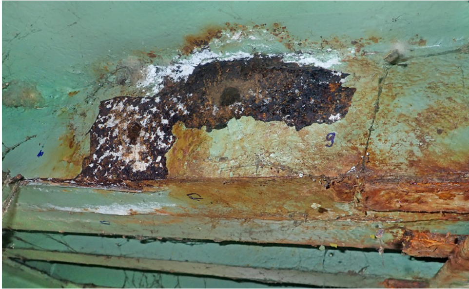
Obr. 3.110. Koroze prvků mostovky Fig. 3.110 Corrosion of bridge deck members
