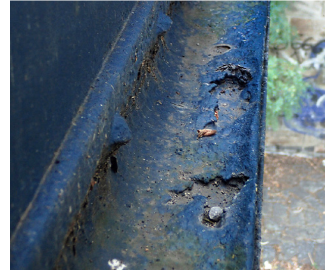
Obr. 3.88. Korozní oslabení krčních úhelníků dolního pásu Fig. 3.88 Corrosion weakening of the bottom chord flange angles
