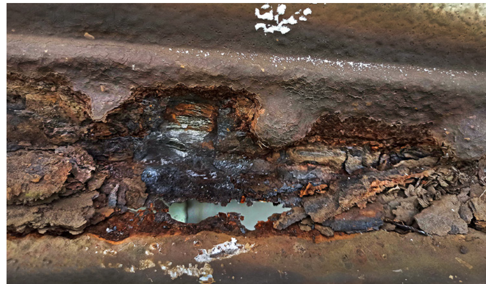
Obr. 3.35. Ukázka rozsáhlého poškození NK na vodorovných prvcích přírub Fig. 3.35 Example of extensive damage to the superstructure on the horizontal flanges
