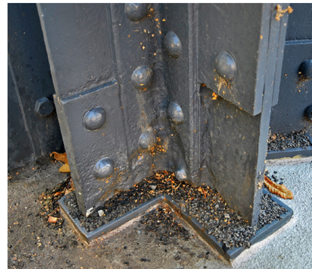
Obr. 3.99. Koroze výplňových prutů hlavního nosníku v oblasti na přechodu skrze konstrukci mostního svršku Fig. 3.99 Corrosion of the main beam diagonals at the passage detail through the bridge superstructure
