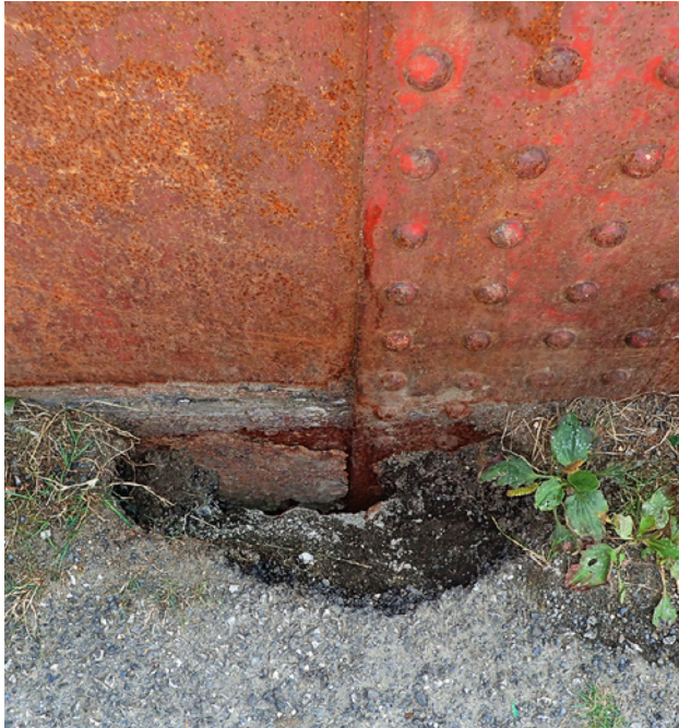
Obr. 3.74. Zatékání do desky mostovky u hlavního nosníku Fig. 3.74 Leakage into the bridge deck slab near the main girder
