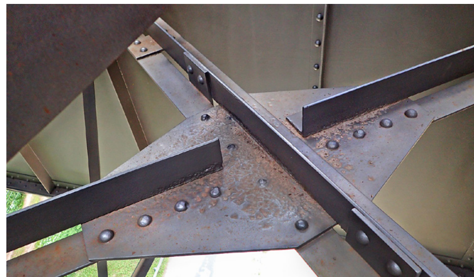
Obr. 3.55. Korozní oslabení v oblasti vodorovného styčnickového plechu vodorovného ztužení Fig. 3.55 Corrosion weakening in the area of the horizontal joint plate of the horizontal stiffening
