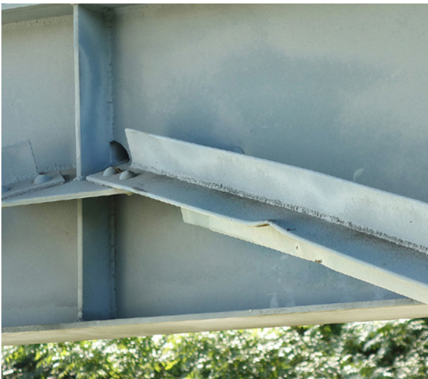
Obr. 3.143. Lokální deformace prutu ztužení Fig. 3.143 Local deformation of the bracing member
