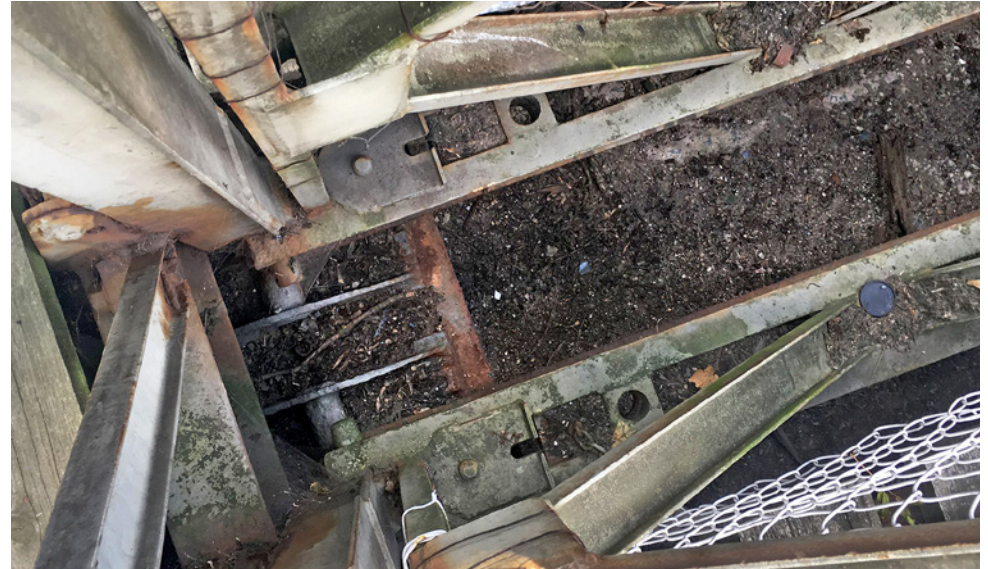
Obr. 3.150. Usazování nečistot při dolním pásu a u ložiska Fig. 3.150 Holding of dirt and dust on horizontal surfaces
