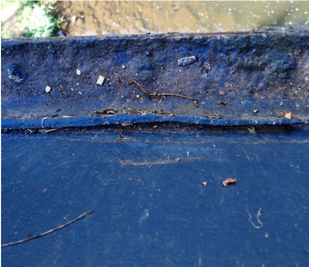
Obr. 3.89. Štěrbínová koroze krčních úhelníků dolního pásu Fig. 3.89 Crevice corrosion of the bottom chord flange angles
