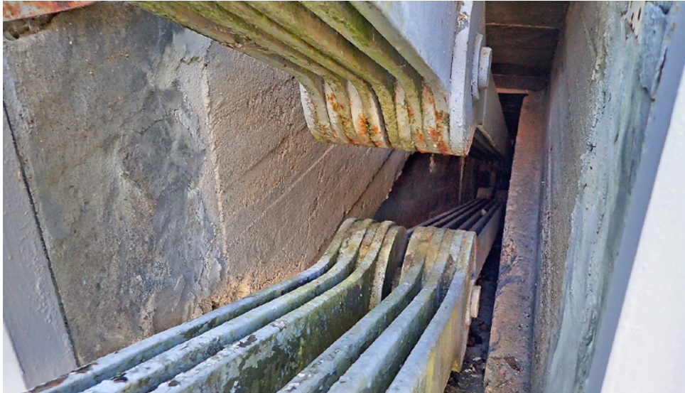
Obr. 3.64. Odlopování protikorozi ochrany a lokální povrchová koroze na člancích řetězu Fig. 3.64 Spalling of corrosion protection and local surface corrosion on chain links
