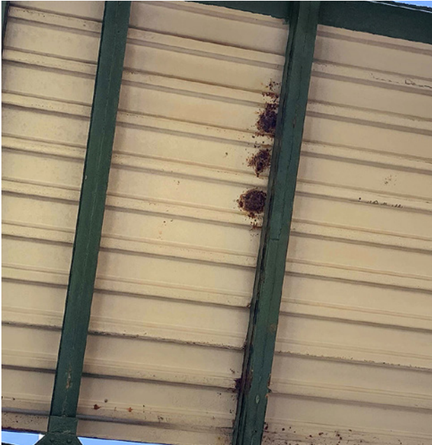
Obr. 3.173. Zatékání pod mostovku a koroze trapézového plechu Fig. 3.173 Leakage of the concrete slab and corrosion of steel decking
