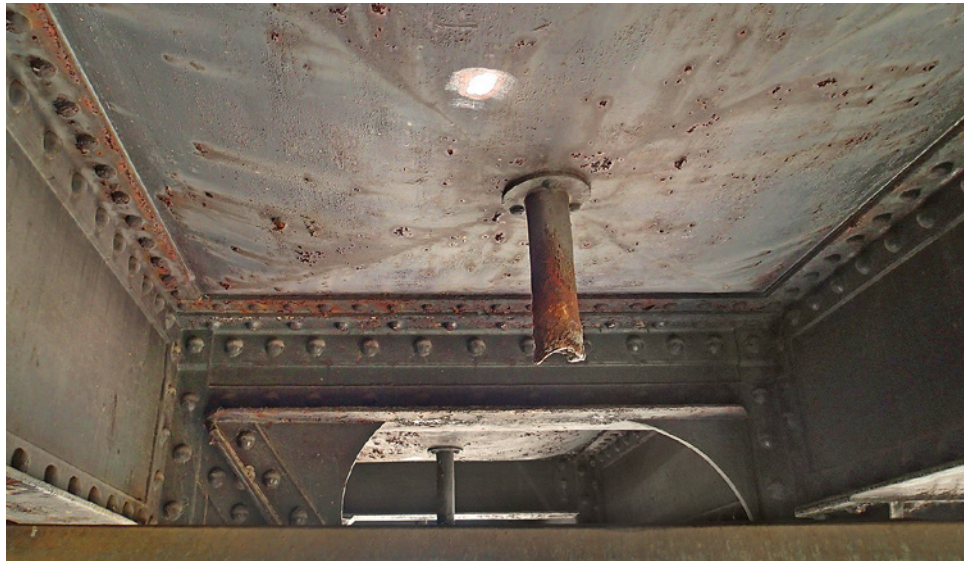
Obr. 3.14. Pohled na dolní líc puklovky s odvodněním v nejnižším místě Fig. 3.14 View of the lower face of the buckle plate with drainage at the lowest point
