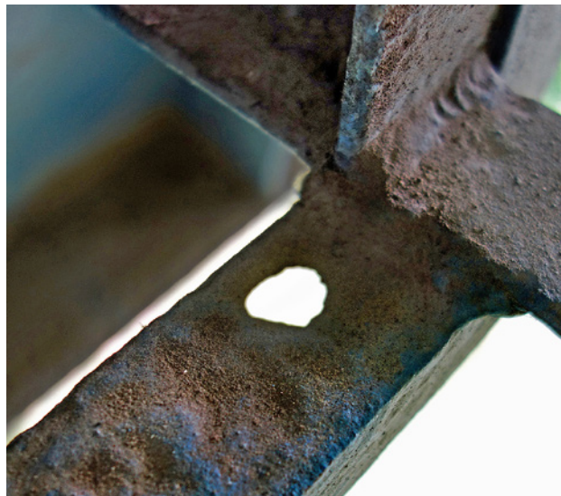
Obr. 3.144. Korozní oslabení prutu revizního zařízení Fig. 3.144 Corrosion weakening of the inspection device rod
