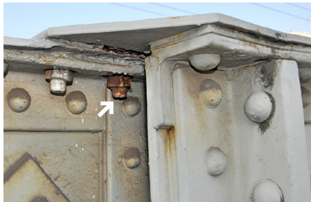
Obr. 3.130. Oválné díry v detailu vloženého kloubu – horní pás Fig. 3.130 Oval holes in the detail of the embedded hinge – upper chord
