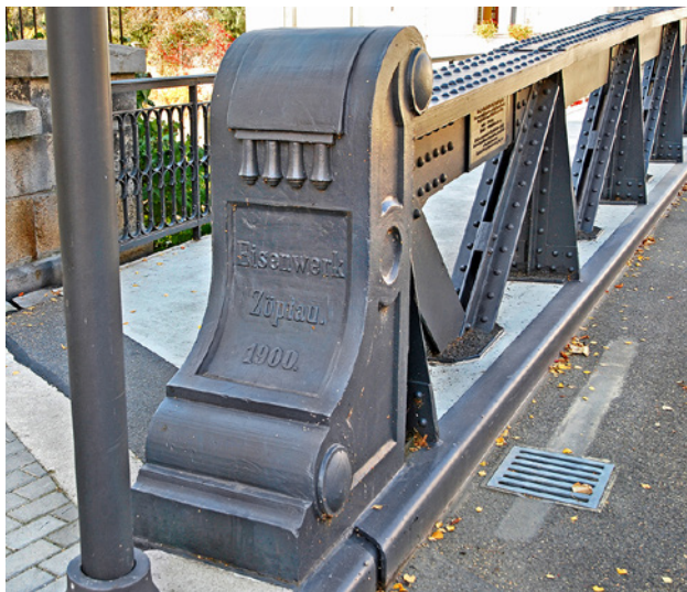
Obr. 3.97. Dekorativní prvek plnící funkci ochrany nosníku před nárazem Fig. 3.97 Decorative casting acting as impact protection for the beam
