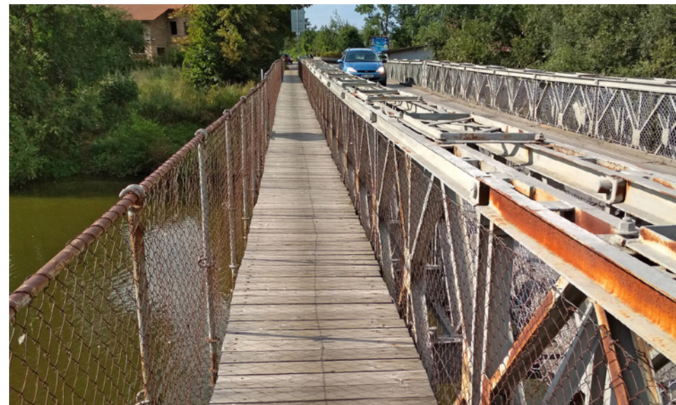
Obr. 3.154. Pohled na zábradelní pletivo bez spodního kotvení Fig. 3.154 The view on the railing, missing lower net fastening
