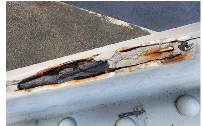
Obr. 3.134. Deformace nosného prvku vlivem štěrbinové koroze Fig. 3.134 Diagonal deformation due to crevice corrosion
