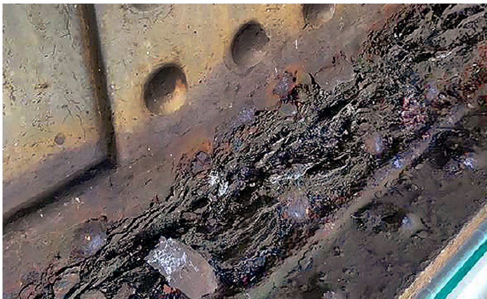
Obr. 3.26. Koroze dolního pásu Fig. 3.26 Bottom chord corrosion
