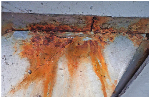
Obr. 3.132. Koroze a zatékání na průchodu diagonály mostovkou Fig. 3.132 Corrosion and leakage at the diagonal through the bridge deck
