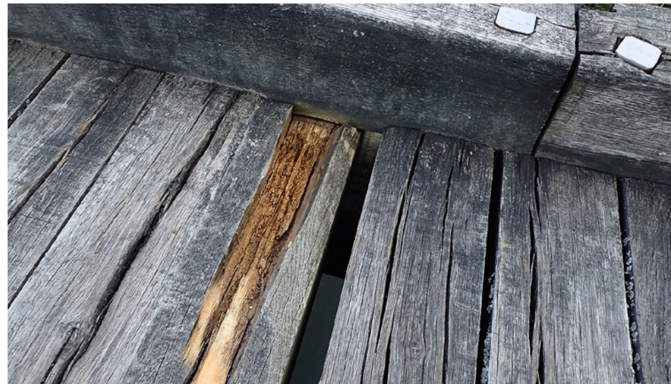
Obr. 3.67. Podélné trhliny a lokální hniloba na dřevěných mostinách Fig. 3.67 Longitudinal cracks and local rot on timber deck
