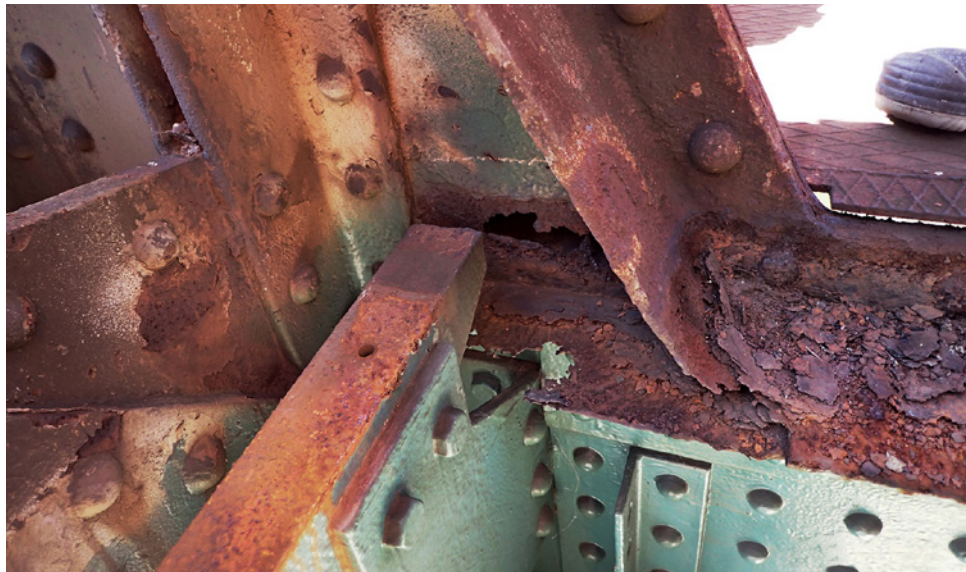
Obr. 3.43. Detail poškození příčníku Fig. 3.43 Detail of the damage to the crossbeam
