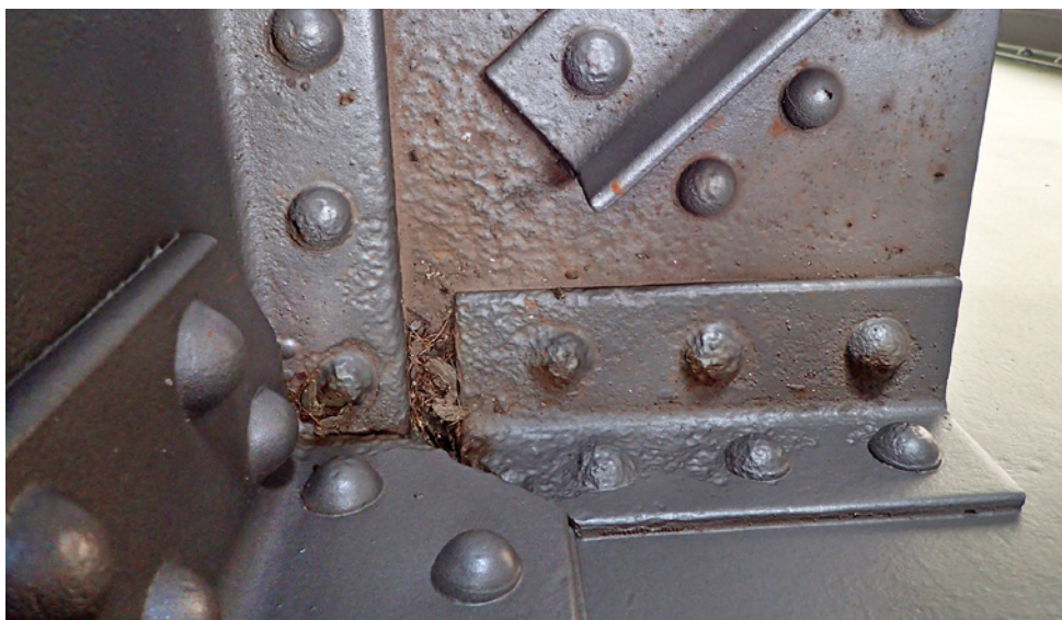
Obr. 3.54. Korozní oslabení styčnickových plechů přípoju vodorovného ztužení Fig. 3.54 Corrosion weakening of the joint plates of the horizontal stiffening connections
