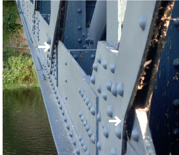
Obr. 3.90. Deformace diagonál v důsledku štěrbinové koroze Fig. 3.90 Deformation of diagonals due to crevice corrosion
