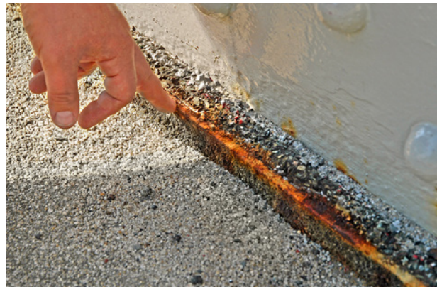
Obr. 3.133. Porucha těsnění na průchodu diagonály mostovkou Fig. 3.133 Seal defect at the diagonal through the bridge deck
