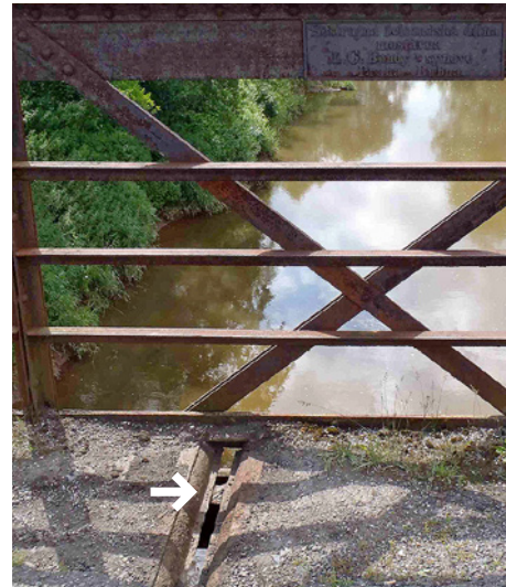
Obr. 3.81. Degradovaná vozovka s odhalenými podlažnicemi Fig. 3.81 Deteriorated concrete deck with exposed decking
