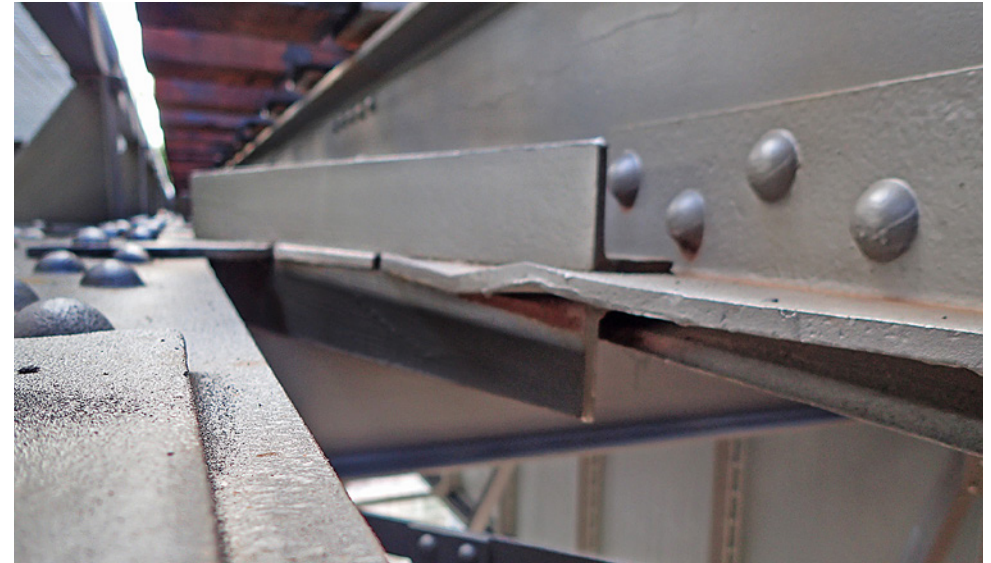
Obr. 3.57. Deformace styčnickového plechu brzdného ztužidla Fig. 3.57 Minor buckling of the horizontal stiffener joint plate
