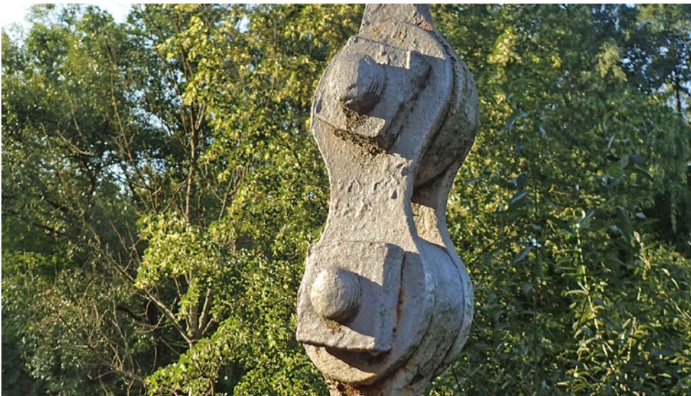
Obr. 3.66. Odlufování protikoroziční ochrany a lokální povrchová koroze na svislém závěsu Fig. 3.66 Spalling corrosion protection and local surface corrosion on the vertical hinge
