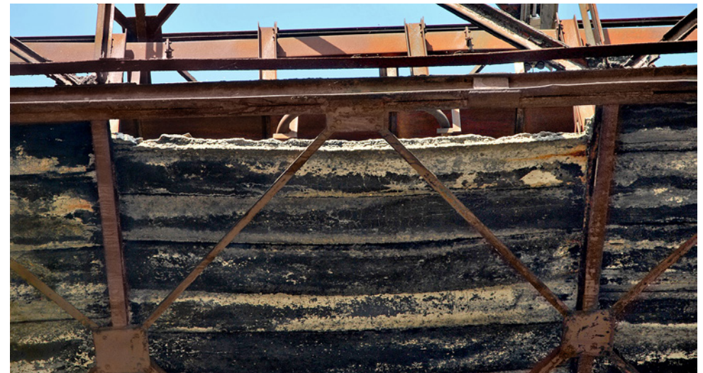
Obr. 3.180. Deformované a rozpadající se panely mostovky Fig. 3.180 Deformed and disintegrated bridge deck panels
