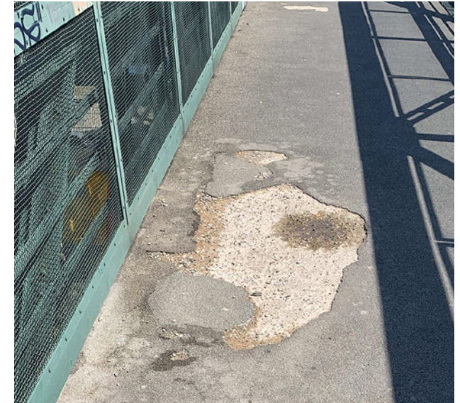
Obr. 3.172. Porušené pochozí vrstvy a usazování vody Fig. 3.172 Deterioration of the deck layers
