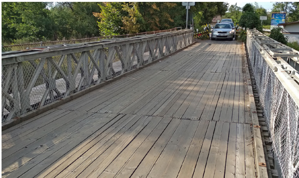
Obr. 3.153. Úžlabí v úrovni kol projíždějících vozidel Fig. 3.153 The timber deck, deformed from the wheel load
