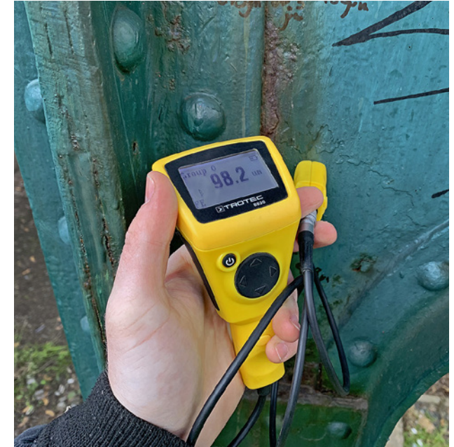
Obr. 3.175. Nedostatečná vrstva protikorozní ochrany Fig. 3.175 Insufficient coating thickness
