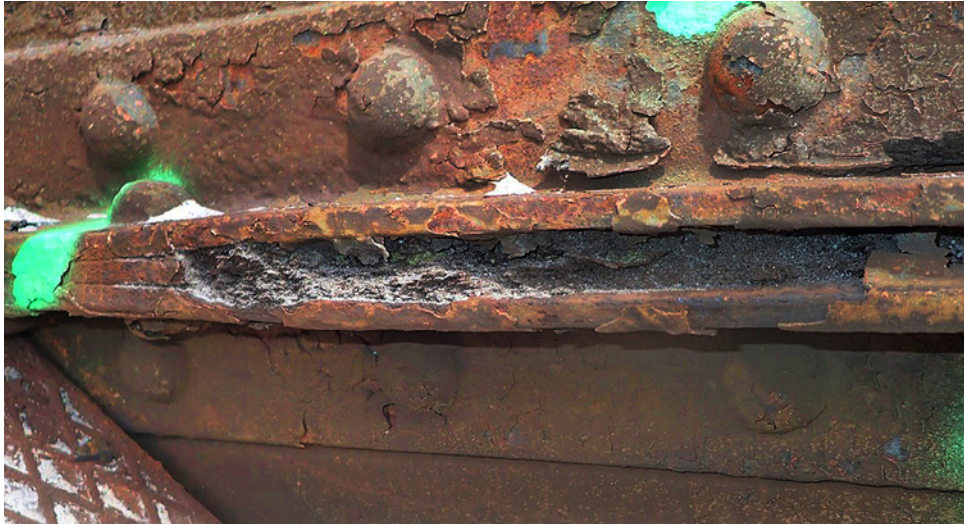
Obr. 3.28 Štěrbina mezi plechy diagonály – před tryskáním Fig. 3.28 The gap between diagonal plates – before blasting
