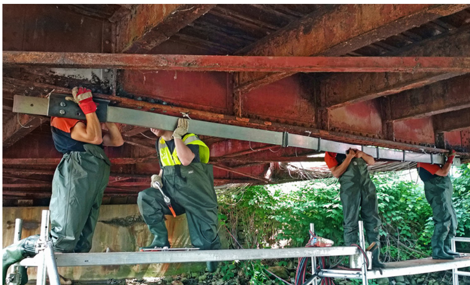
Obr. 1.51. Zesílení příčnicku historického ocelového mostu pomocí SMA Fig. 1.51 Strengthening the crossbeam of a historic steel bridge with SMA
