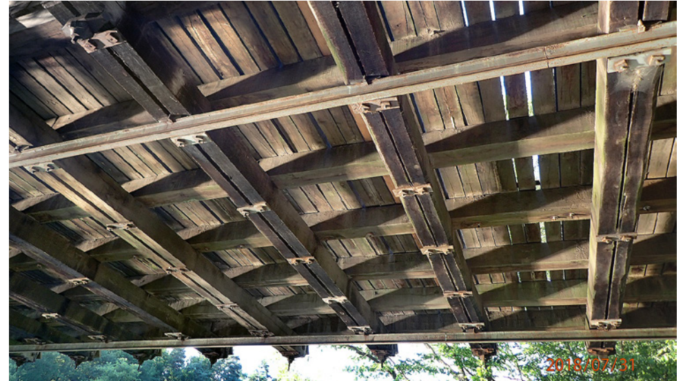
Obr. 3.61. Pohled na dolní líc dřevěné mostovky Fig. 3.61 View of the lower face of the timber bridge deck
