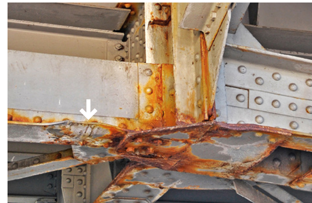
Obr. 3.131. Korozíe prvků v oblasti vloženého kloubu, nadměrná deformace pásnice dolního pásu po nárazu vozidla Fig. 3.131 Corrosion of members in the detail of the embedded hinge, excessive deformation of the bottom chord flange from the vehicle impact
