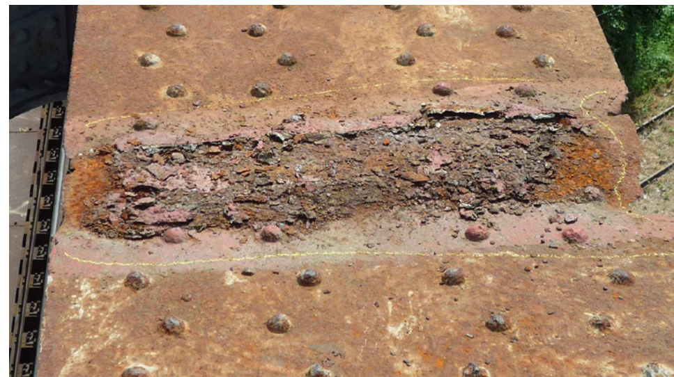
Obr. 3.46. Dolní pás, nánosy korozních produktů Fig. 3.46 Lower flange, deposits of corrosion products
