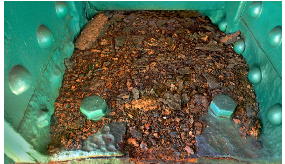
Obr. 3.44. Dolní pás, nánosy korozních produktů Fig. 3.44 Lower flange, deposits of corrosion products
