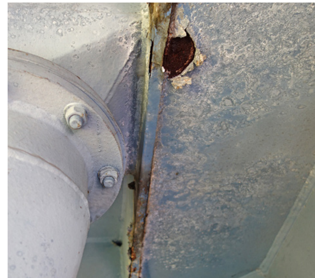
Obr. 3.145. Lokální koroze mostovky Fig. 3.145 Local corrosion of the bridge deck
