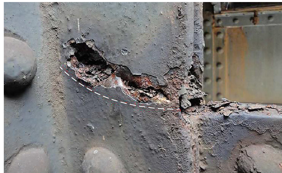
Obr. 3.27. Štěrbinová koroze Fig. 3.27 Crevice corrosion
