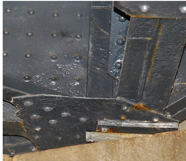
Obr. 3.101. Korozní oslabení vodorovných styčnickových plechů Fig. 3.101 Corrosion weakening of horizontal contact plates
