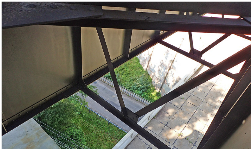
Obr. 3.52. Pohled do prostoru dolních pásnic hlavních nosníků – absence vodorovného ztužení Fig. 3.52 View into the space of the lower flanges of the main beams – absence of horizontal bracing
