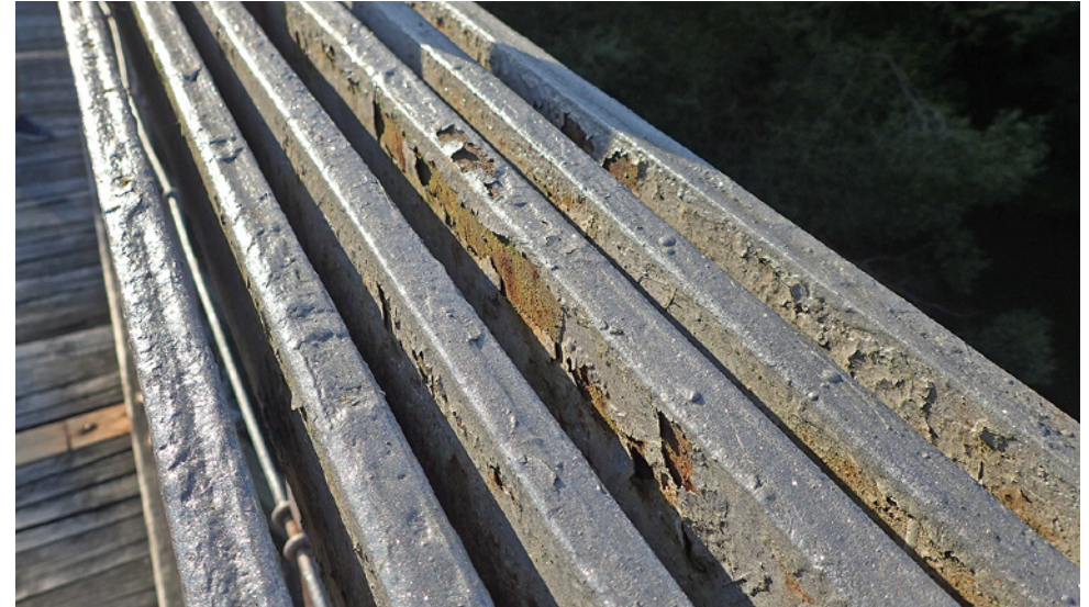
Obr. 3.65. Odlopování protikorozi ochrany a lokální povrchová koroze na člancích řetězu Fig. 3.65 Spalling of corrosion protection and local surface corrosion on chain links
