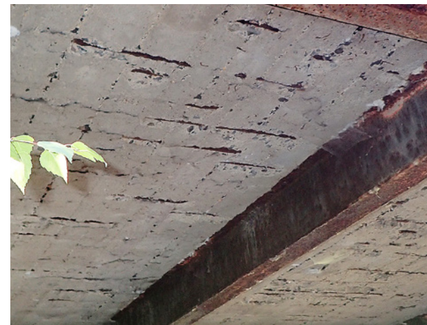
Obr. 3.73. Obnažená výztuž desky mostovky Fig. 3.73 Exposed reinforcement of the concrete slab
