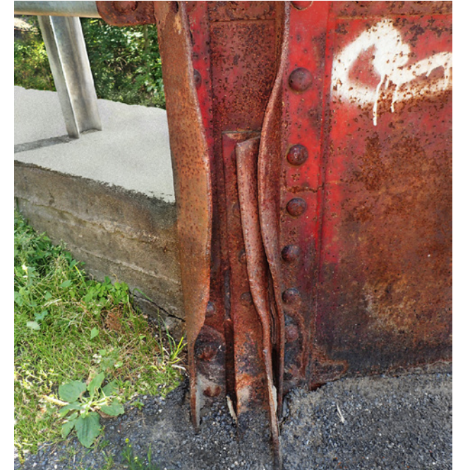
Obr. 3.76. Deformace svislých výztuh v důsledku nárazu vozidla Fig. 3.76 Deformation of vertical bracing due to vehicle impact
