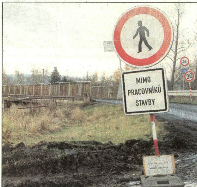
Nejen zákaz vjezdu, ale i vstupu je na opravovaném mostu přes Mži v Plzni-Křimicích. Dodatková tabulka dokonce říká, že je most zrušen. Foto Roman Kočí
