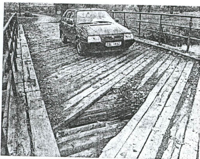
Most přes řeku Mži v Radčicích je prakticky v dezolátním stavu. Foto J. VOGELTANZ
